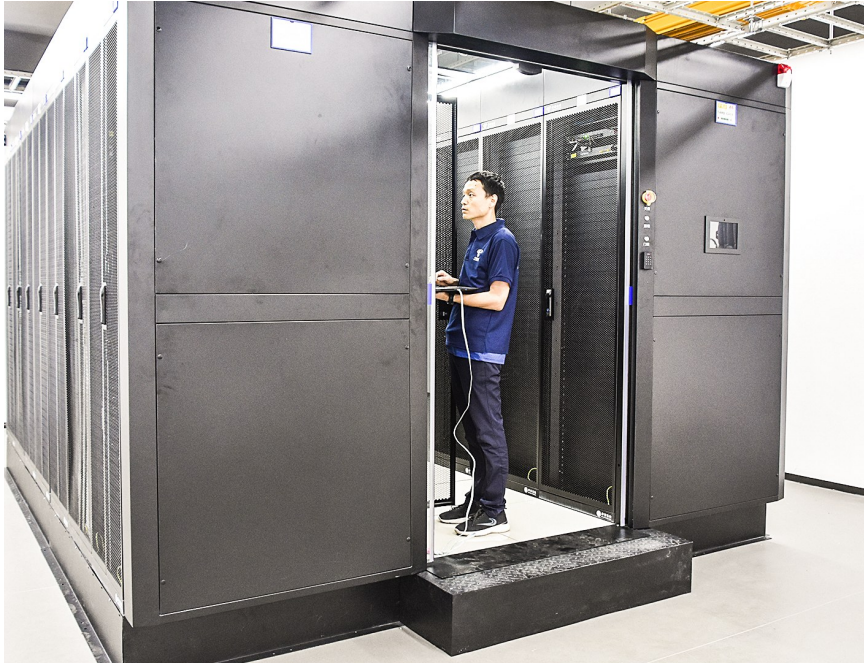
边缘云计算中心机房内的一期数据机房
