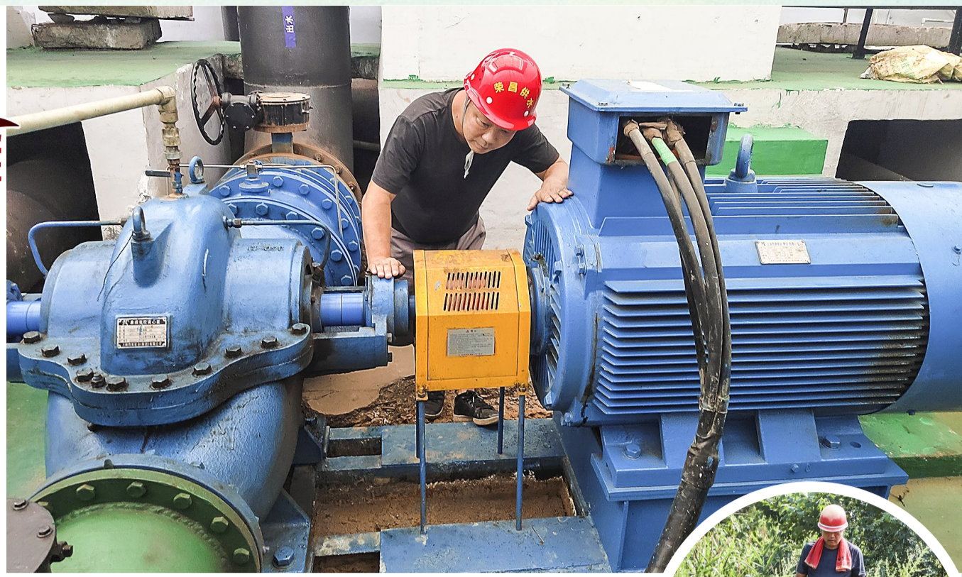
泵站工作人员检查取水设备运转情况
