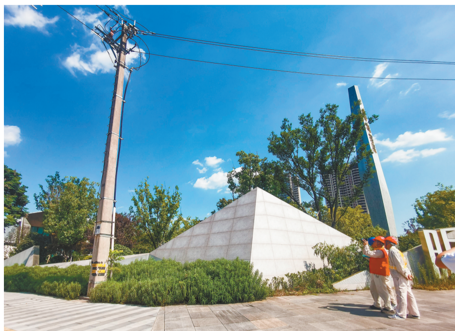
用红外线测温仪检测电网重要连接点
